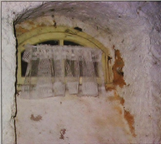
Feuchte Schäden vor der Innendämmung eines denkmalgeschützten Hauses.
