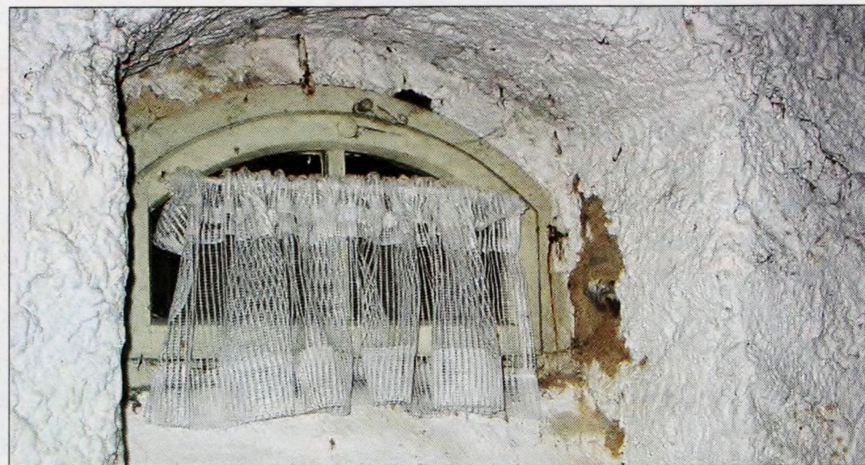
Feuchte Schäden vor der Innendämmung eines denkmalgeschützten Hauses. (Foto: pv)
